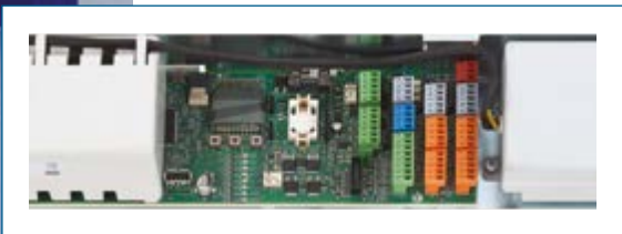
Unidad de control con fuente de alimentación conmutada.
